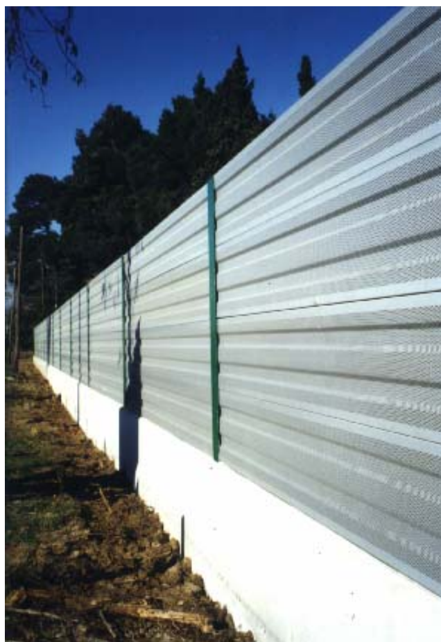
Φωτογραφία του ηχοπετάσματος.
